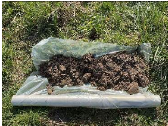
Foto 17: Asbestgat t.p.v. dammetje (G05)
